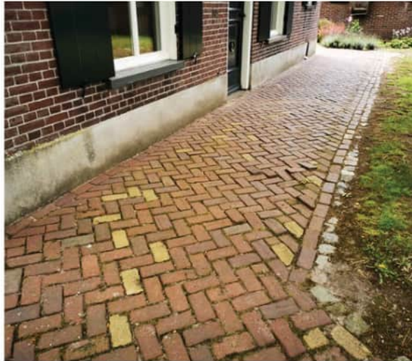
Beeld 7. Schade door wortels es aan fundering en verharding
