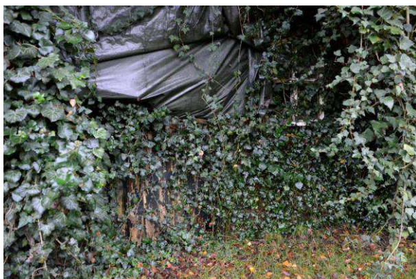
Door de begroeiing en afdekking heen is nog een loopdeur en stalraam zichtbaar
