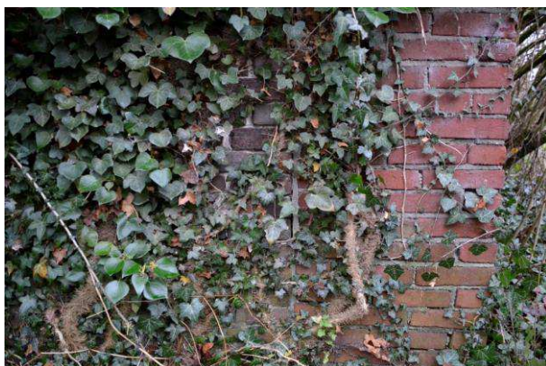
Verticale naad in het metselwerk rechts in de achtergevel.
