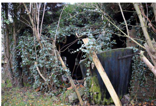
Het ingestorte deel van de voorgevel
