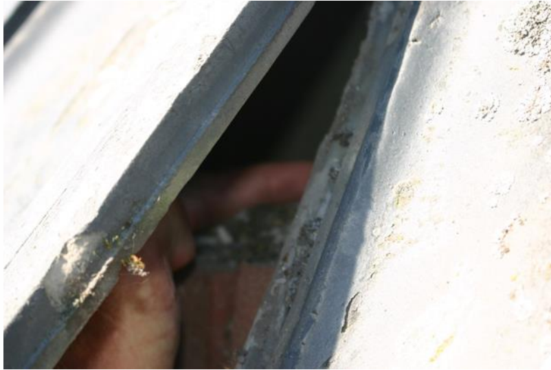
Figuur 4.4.3 De spouw van het woonhuis is niet toegankelijk aan de bovenzijde.
