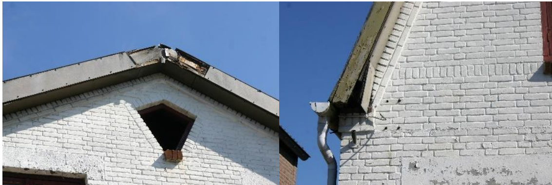
Figuur 4.4.4 De beschadigde windveer aan de voorgevel.
